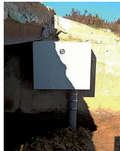
Fig. 2.- Estación para el registro continuo de conductividad eléctrica.
