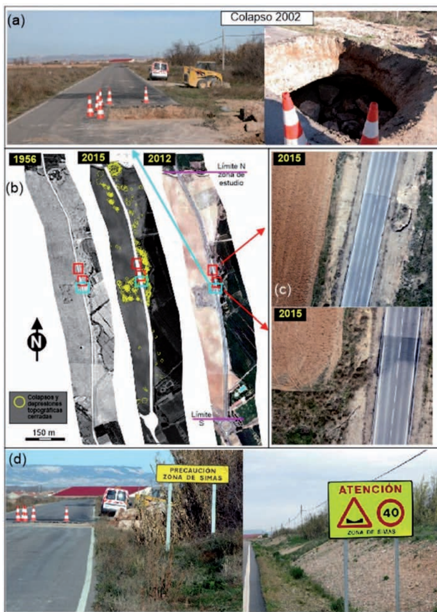
Fig. 2.- Contexto histórico-geomorfológico de los colapsos de la carretera Luceni-Boquiñeni. a) Fotografías del colapso de 2002. b) Fotografías históricas y recientes de la zona (la cartografía geomorfológica se basa en el análisis de 18 vuelos aéreos: 1927-2015). c) Aspecto de la carretera en el vuelo de dron de 2015. d) Modificación de las señales viarias previamente y posteriormente a las actuaciones en la carretera (nótese el cambio topográfico de los arcenes tras la excavación del vial). Ver figura en color en la web.
