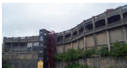
Fig. 1.- Fachada noroeste de las Galerías de Punta Begoña en su estado actual.
