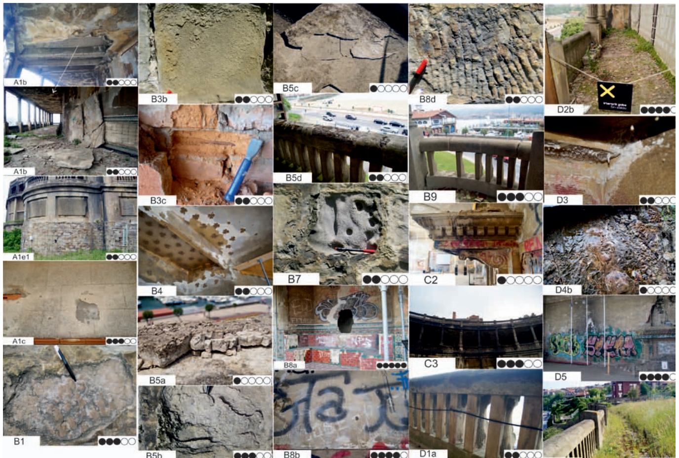
Fig. 3.- Alteraciones principales reconocidas en el edificio con su denominación en la clasificación y su grado de afección.
