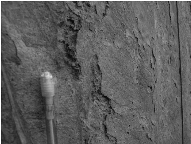
Fig. 4.- Escamas formadas en la superficie del frente de la cantera "La Carrasca".
