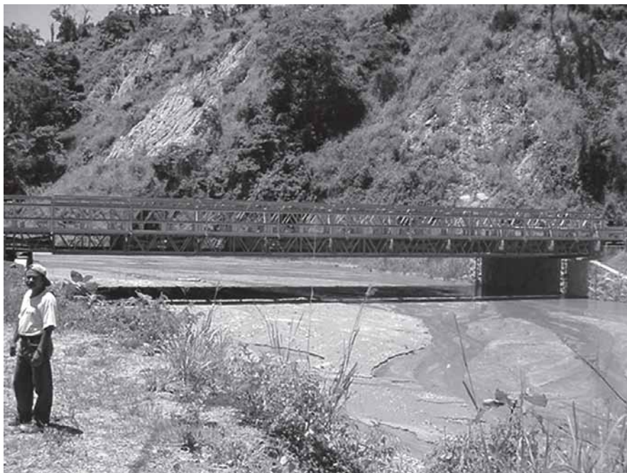
Fig. 4.- Fotografía tomada en el río Desagüe, en la ladera del Ilopango. El puente fue construido originariamente sobre un cauce más profundo ahora totalmente colmatado. Pueden verse al fondo los derrumbamientos producidos por el terremoto de 2001, erosionados y agrandados por las fuertes lluvias de la zona.
