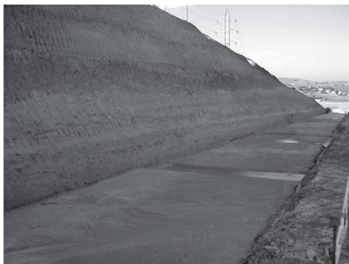
Figura 9.- Taludes excavados en los materiales de la unidad TG granular.
